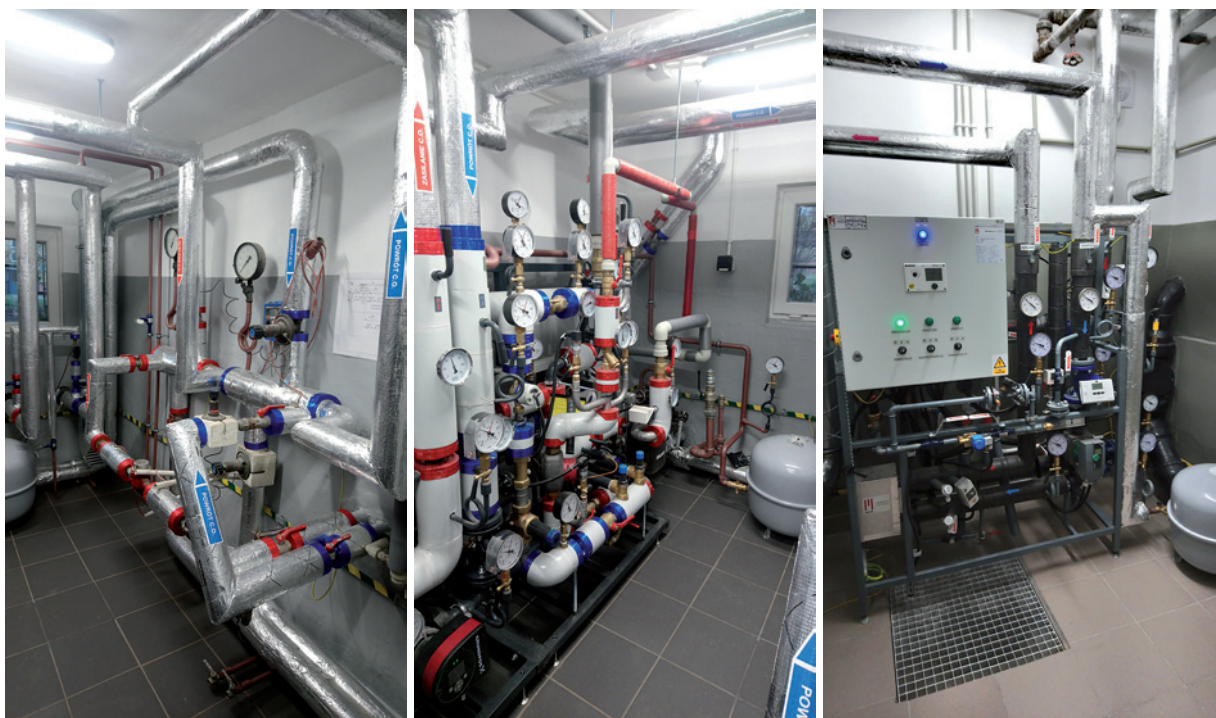
Fot. 8. Modernizacja Systemu Ciepłowniczego w Pyskowicach – węzły ul. Dworcowa 24, Dworcowa 28, Wojska Polskiego 8A
